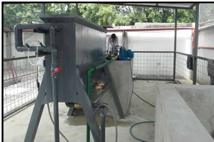
TANQUE REACTOR BIOLÓGICO
