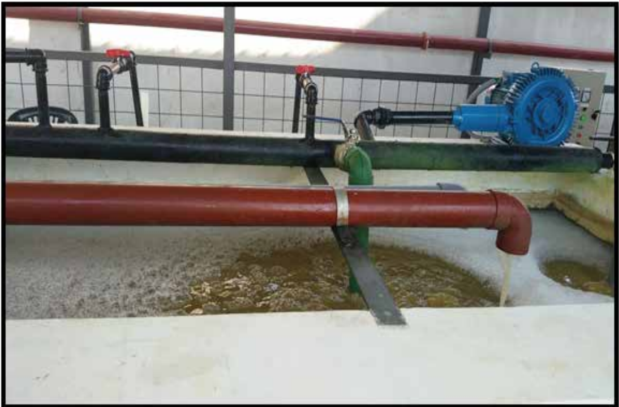
TANQUE REACTOR BIOLÓGICO
